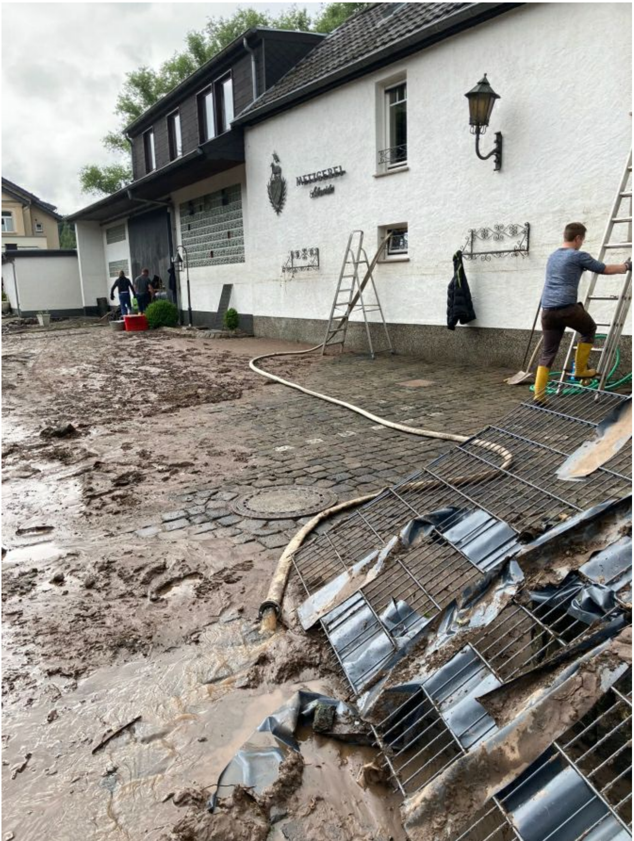
Hochwasserschaden im Juli 2021
