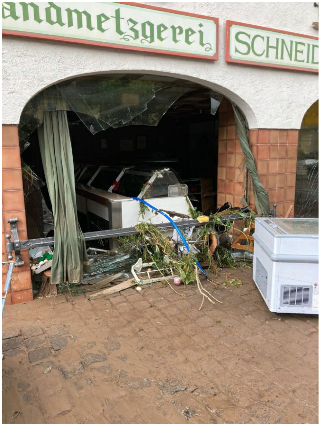
Hochwasserschaden im Juli 2021
